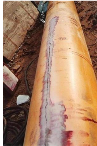
Corrosión Bajo Tensión (originado en su periodo de almacenamiento) de una Tubería de Acero Inoxidable Recién Instalada
