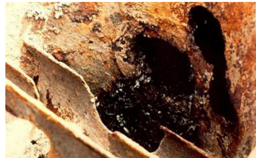
Corrosión de la Succión de una Bomba de Circulación de Agua de mar en un Circuito de Enfriamiento, con evidencia de Corrosión y crecimiento de Colonias Algas y Moluscos (Bio-Fouling)
