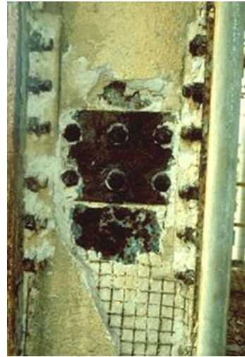
Corrosión bajo el Recubrimiento Retardador de Fuego en una Estructura Industrial
