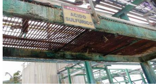
Corrosión de una Estructura junto a un Tanque de Almacenamiento de Ácido Sulfúrico
